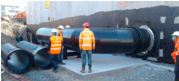
Nouveau bâtiment de pompage des eaux traitées
