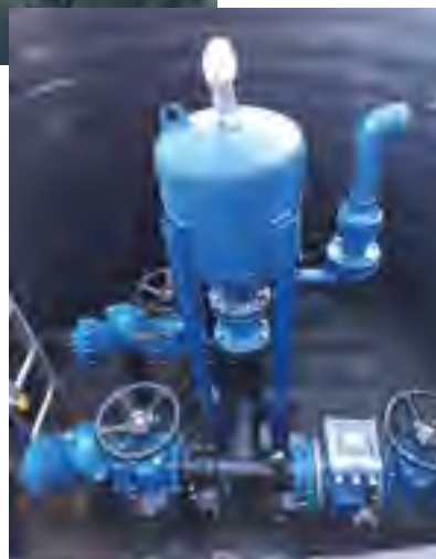
Poste de refoulement Audubon (ZAC Doulon-Gohards)
