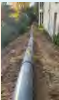
Canalisation provisoire aérienne
