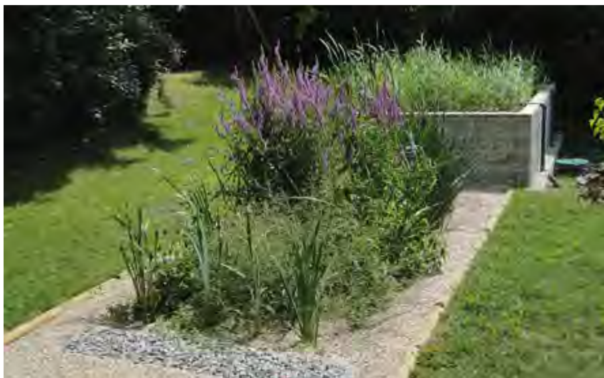
Filtres plantés, un assainissement non collectif naturel
