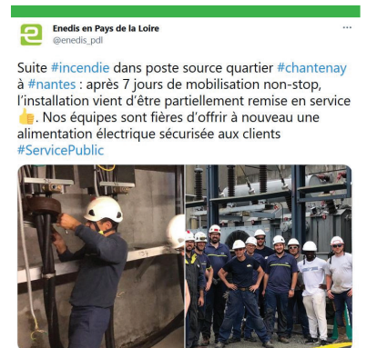
Incidents poste source de Chantenay
